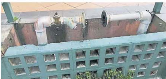
水表被切断，居民面对断水。
