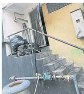
类似非法驳接管线的画面在该商业区随处可见。
